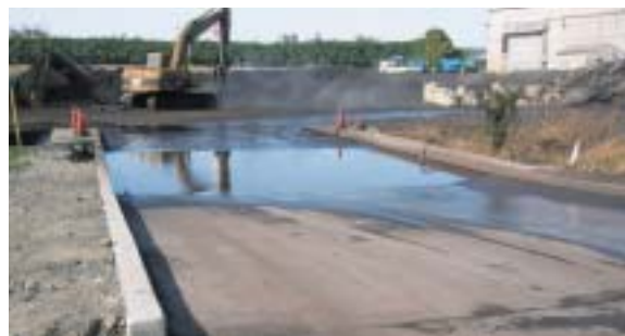
新設されたタイヤ洗い場
