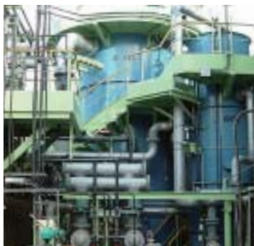
刈谷工場の排水フッ素除去設備
