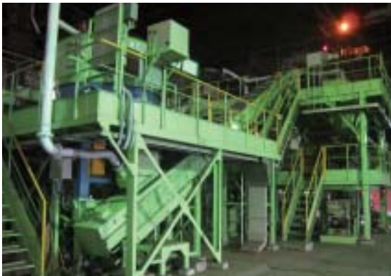
知多工場に設置されたブリケット製造設備
